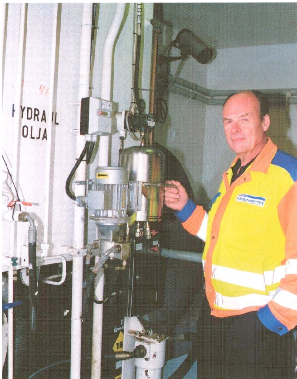
Det första Europafiltret monterades på hydraulsystemet. Det löste problemet med vatten i rapsolja. En separat cirkulationspump pumpar oljan genom filtret.
